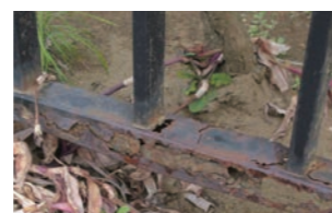
フェンス全体に腐食が進んでいました
